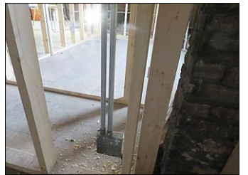
NEW CONDUIT PIPES
